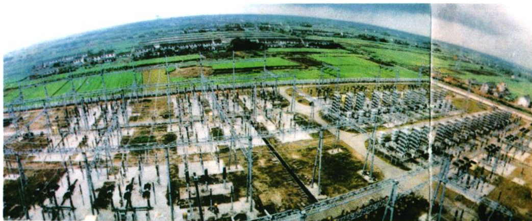
上海南桥 50 万伏变电站——中建总公司优质工程
