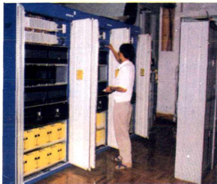
程控电话机房
