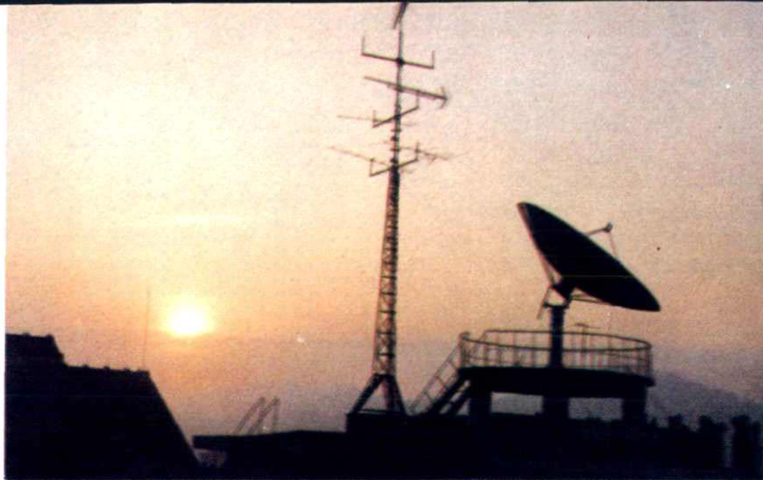
卫星电视广播地面接收设施
