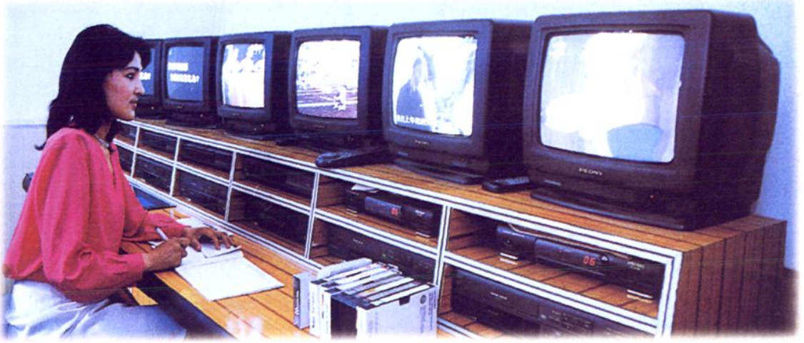
20世纪90年代电视台录播机房
