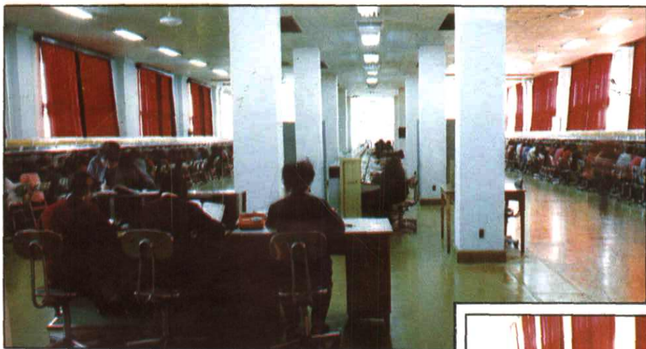
濟南市電信局長途電話交換臺全景
