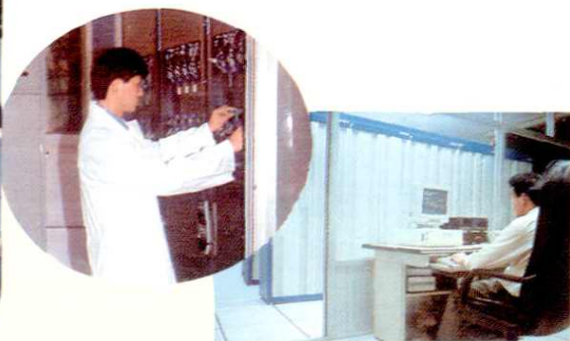
程控电话机房
