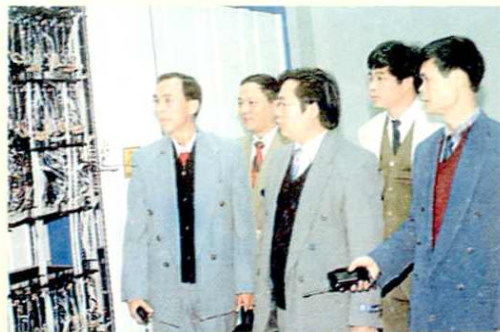
局领导深入程控电话机房检查工作(1995年12月)
