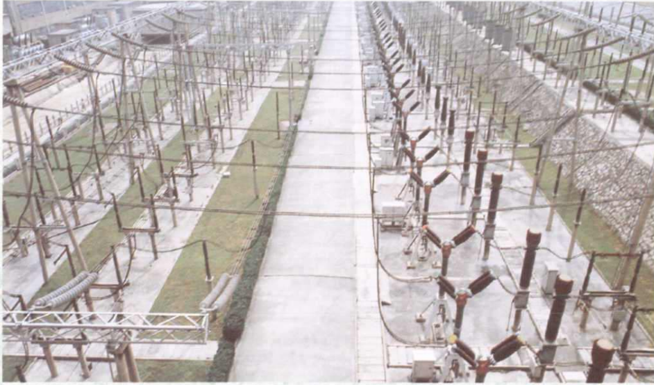
1981年11月,全国第一条500千伏输电线路姚孟升压站投入运行
