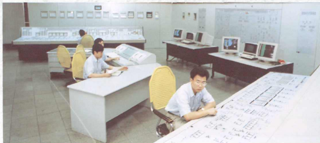
3、4号机组控制室
