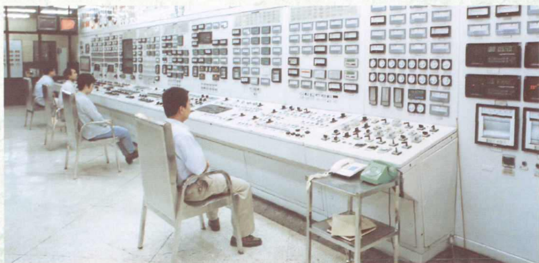
1号机组控制室
