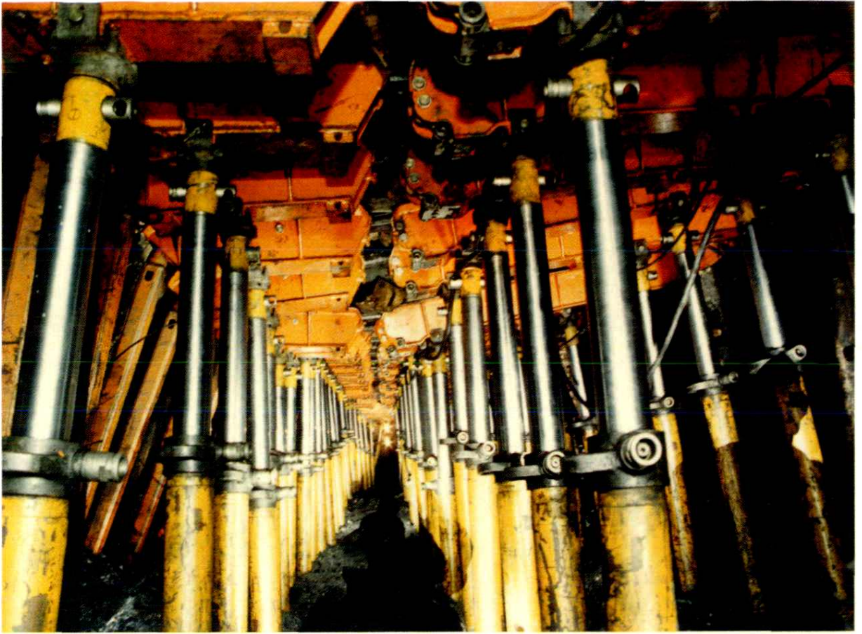
井下滑移顶梁支护
