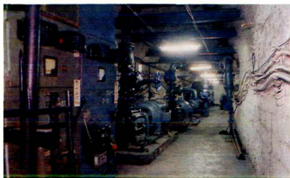
井下排水泵房
