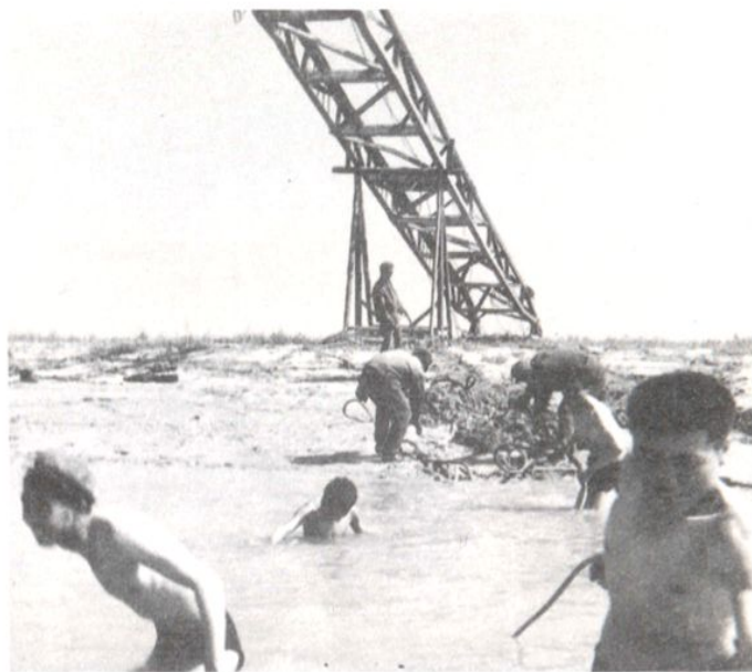
被石油部命名为“钢铁作业三队”的职工在埕东油田涉水过河,抢装作业井架
