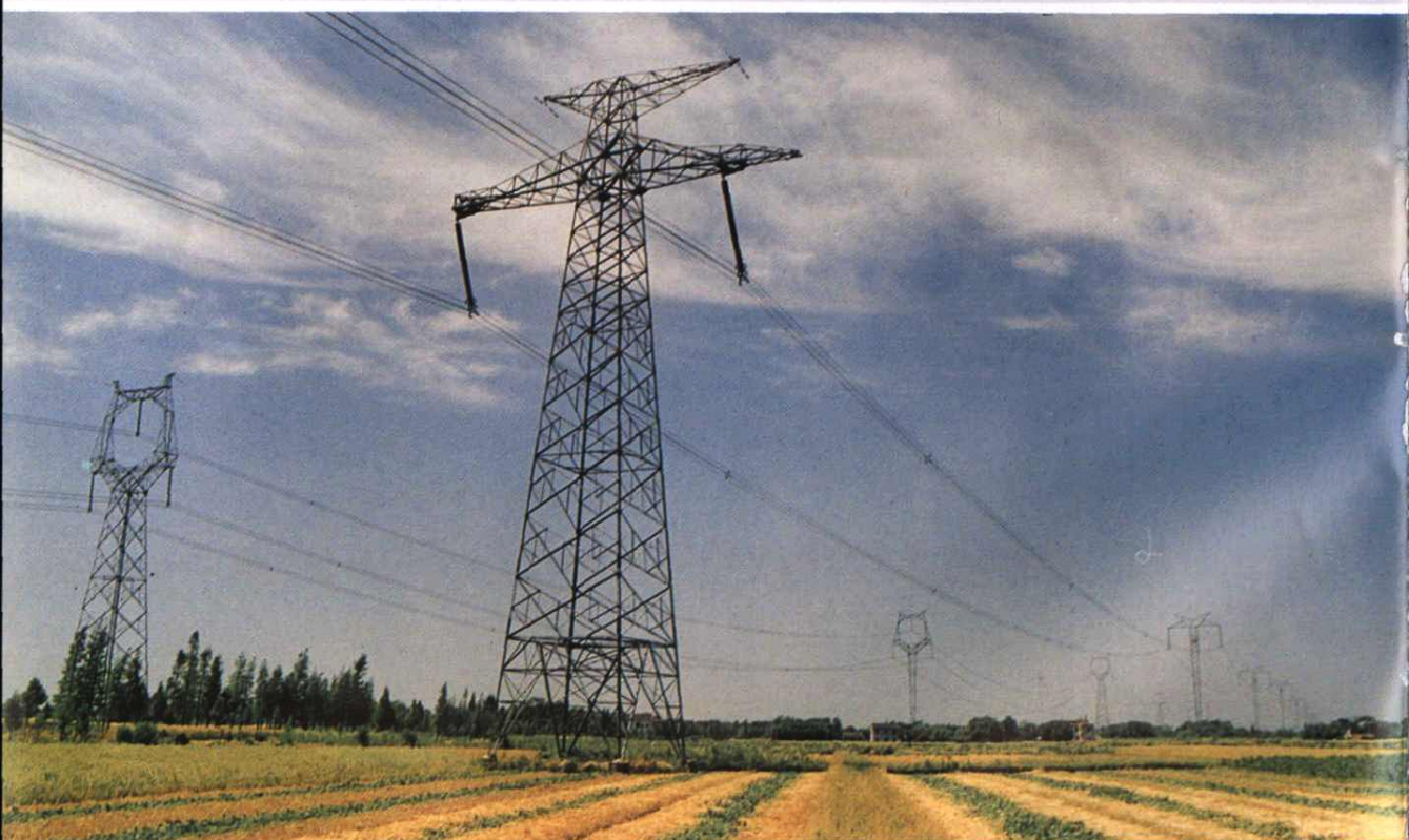
1990年8月5日，中国第一条500千伏葛洲坝—上海直流输电线路双极投入运行。图为嘉兴境内线路
