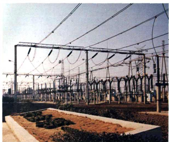
1987年7月24日，220千伏双山变电所投入运行
