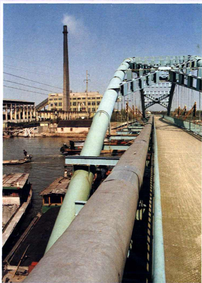
1991年12月3日，嘉兴热电厂第一台1.2万千瓦发电机组投产。图为电厂供热管道
