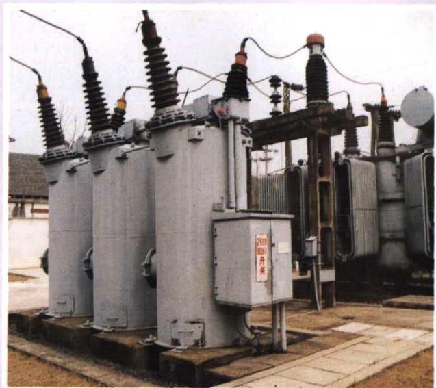
1961年7月14日投运的110千伏嘉兴变电所
