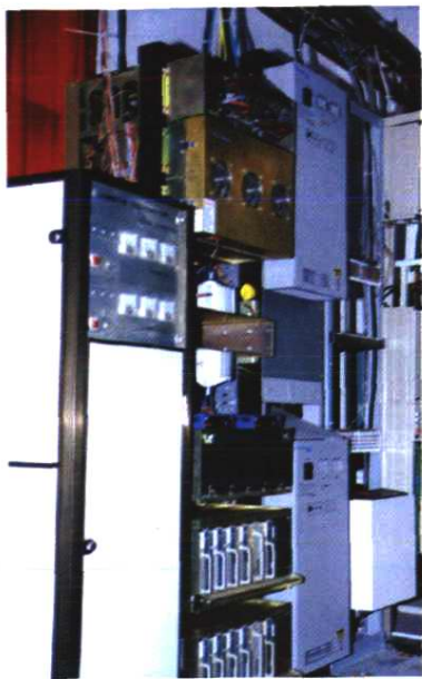
移动通信机房
