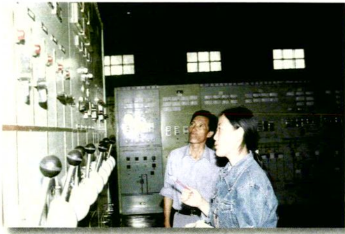
大柳塔 110KV 变电站
