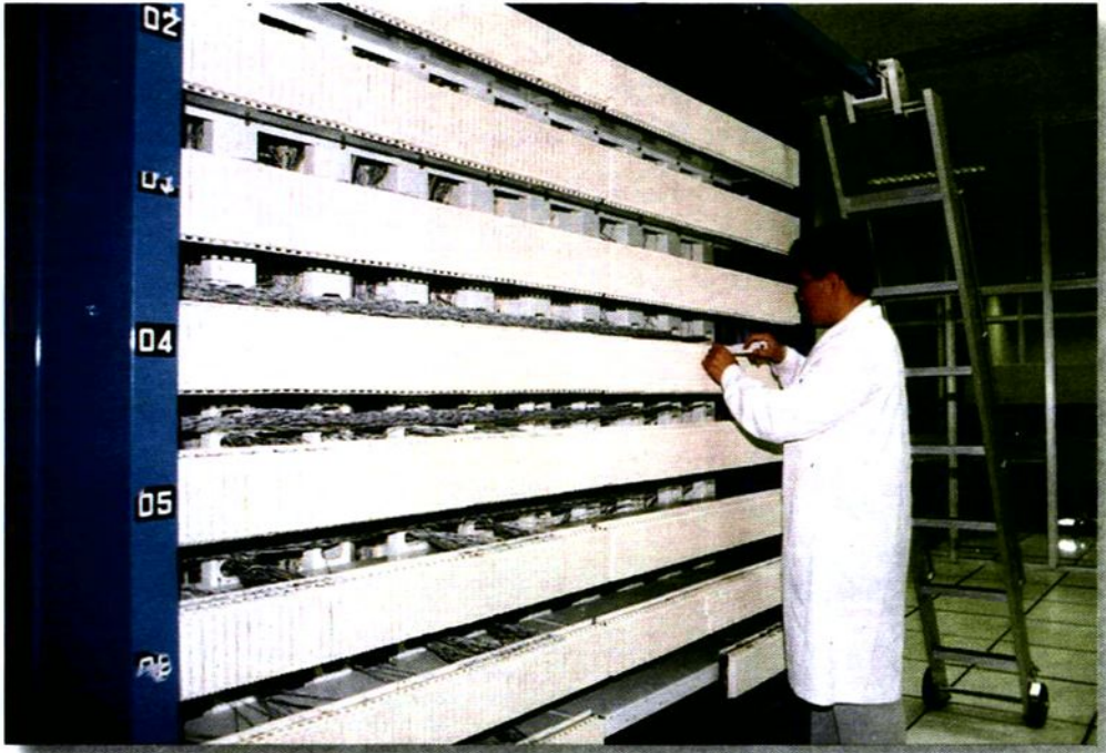
数字程控电话机房
