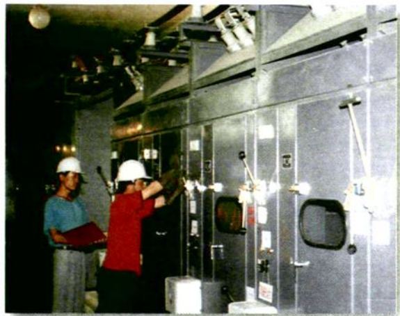
松定霍洛 110KV 变电站
