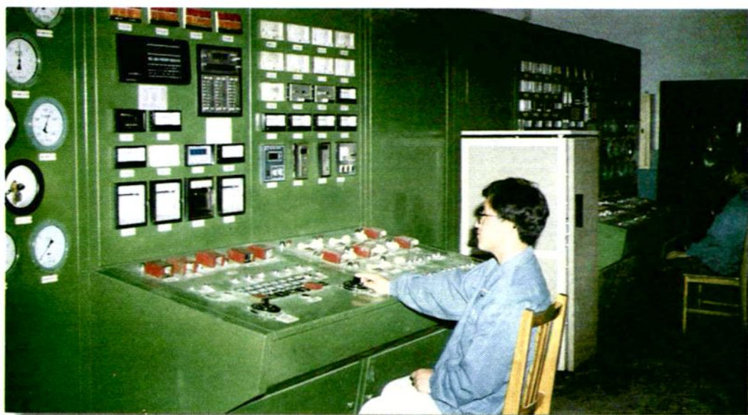
2 × 12MW 电厂汽轮机控制室
