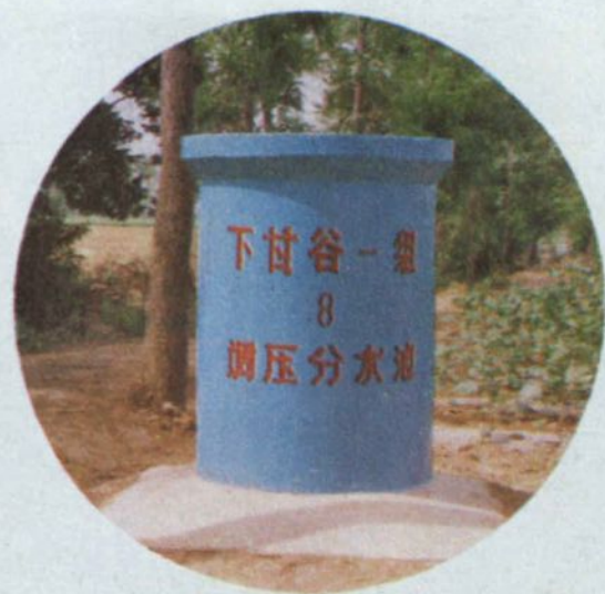
管村地下暗管一角
