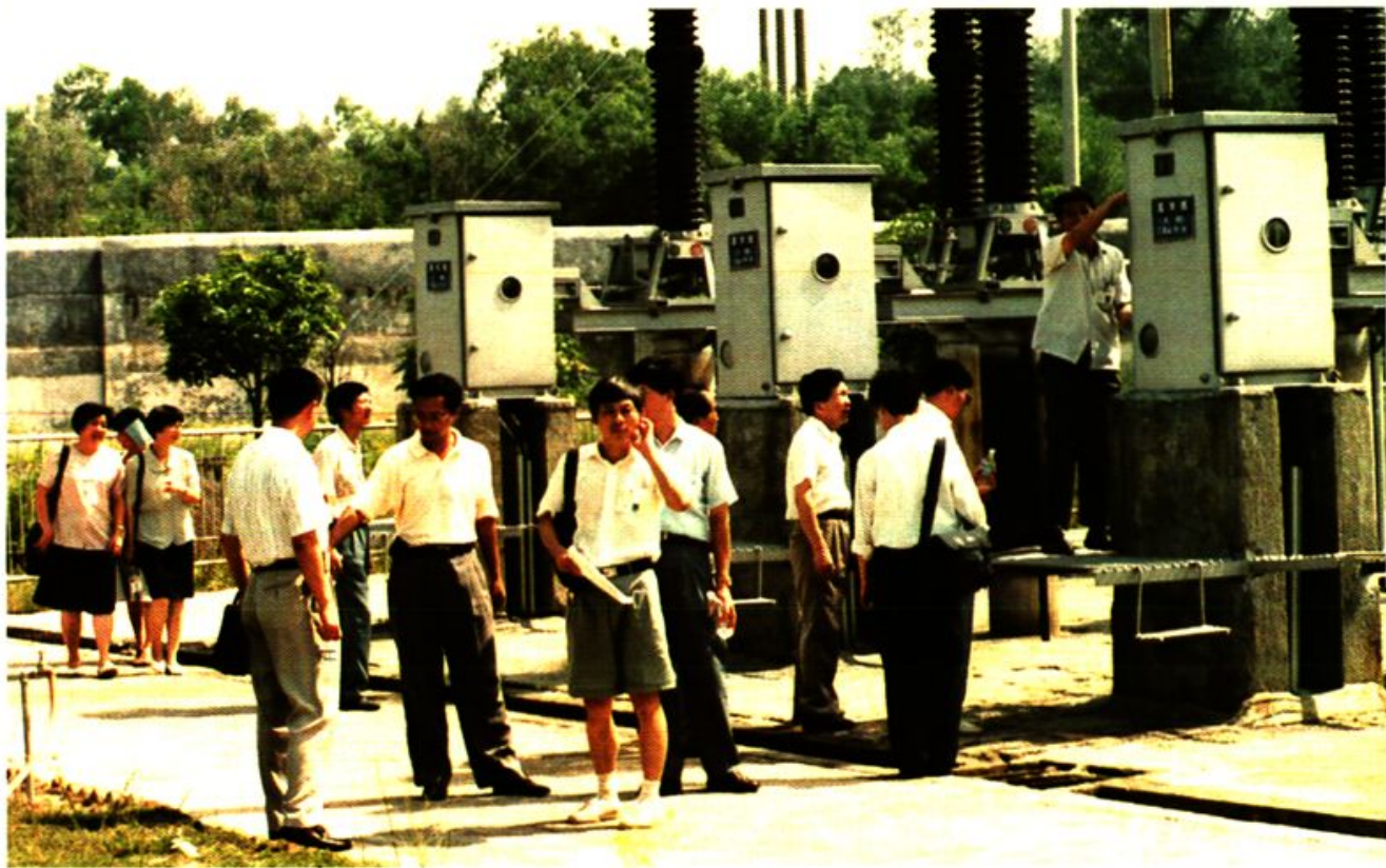
20 检查变电站“安全文明生产双达标工作”
