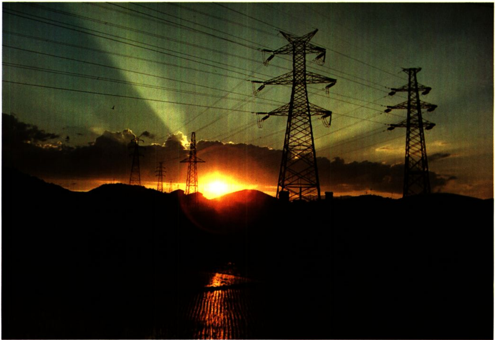
5 220 千伏进岛输电线路
