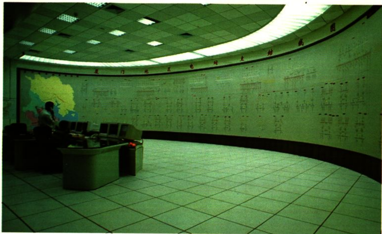
7 厦门地区电力调度室
