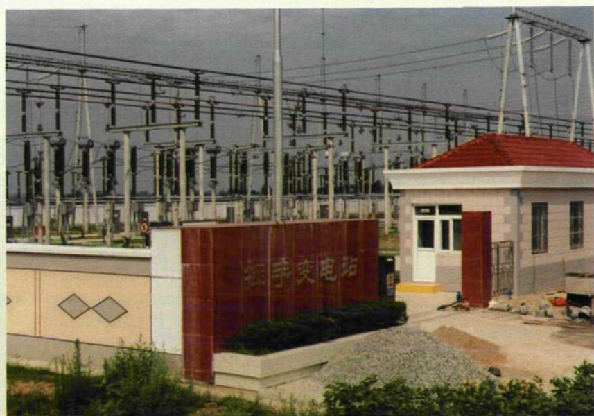
220千伏挥手变电站
