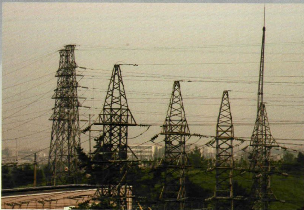
高压输电线路
