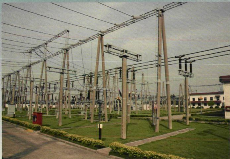
220千伏春秋塘变电站
