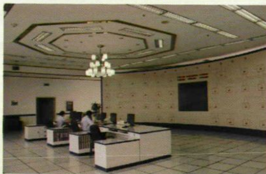
六安电力调度大厅
