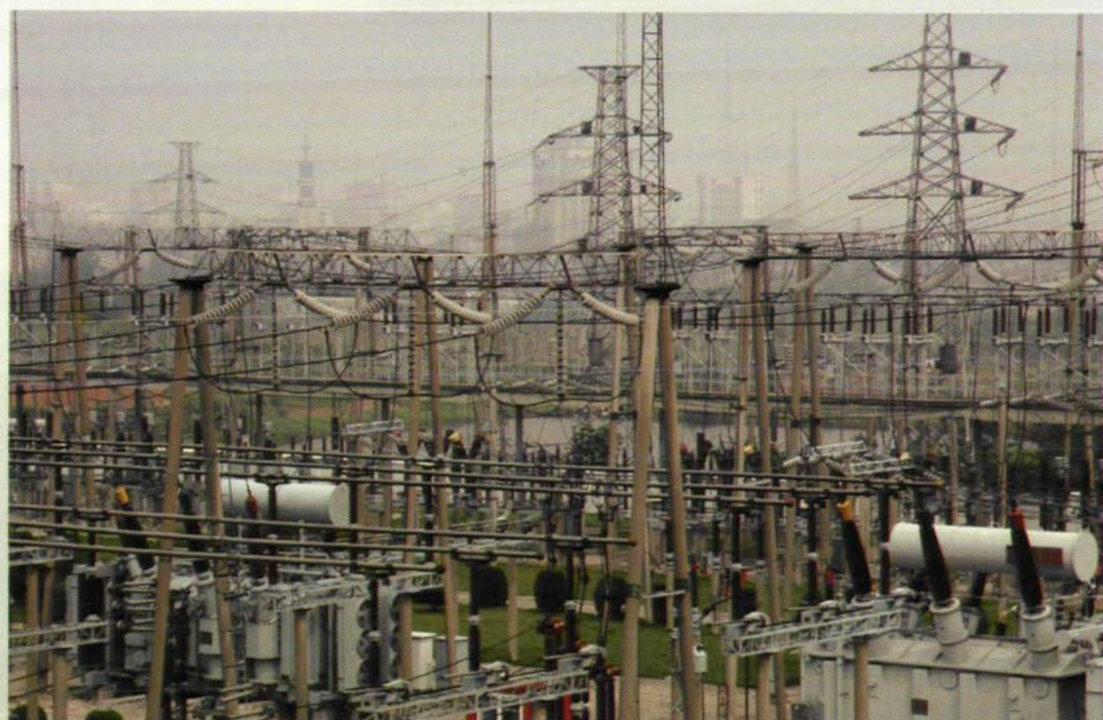
220千伏六安变电站
