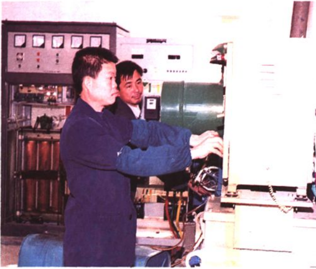
技术人员在电力室调调整流器电压
