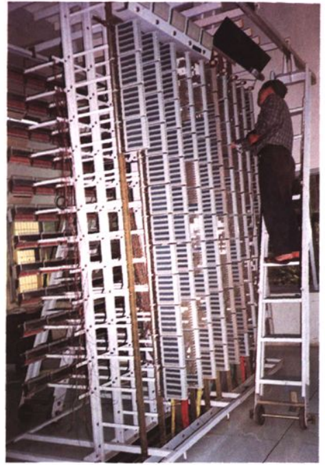
机务员在配线室工作
