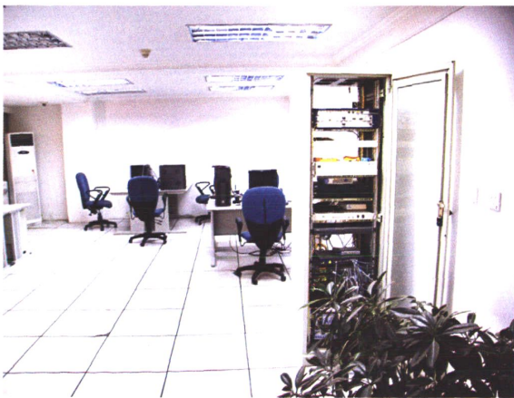
区联社计算机中心机房
