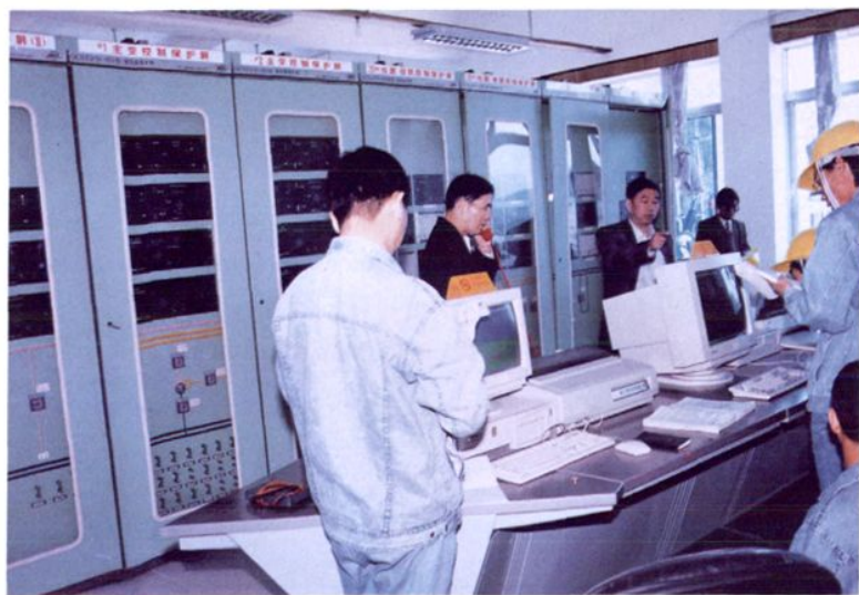
清远市第一座无人值班110千伏龙头山变电站(新站, 1996年11月投产)
