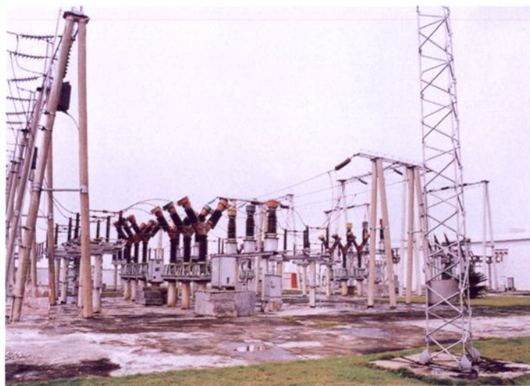
清远市第一座110千伏石角变电站(1966年4月投产)
