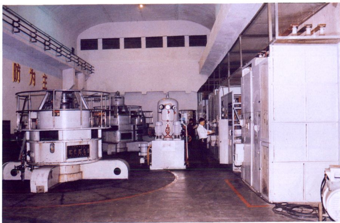
连州市潭岭水电厂装机容量 3 \times 1.25 万千瓦(1969年建成)
