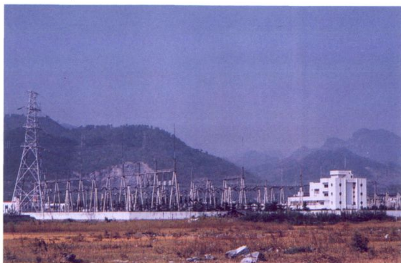
220千伏阳山变电站 远眺(1995年6月投产)
