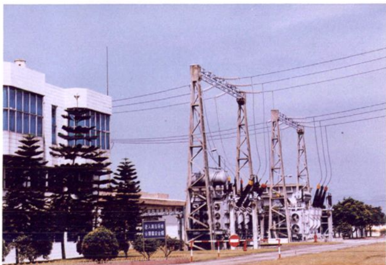
清远市第一座220千伏清远变电站(1989年4月投产)
