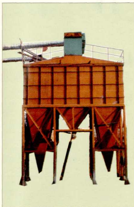
正压气力干除灰系统
