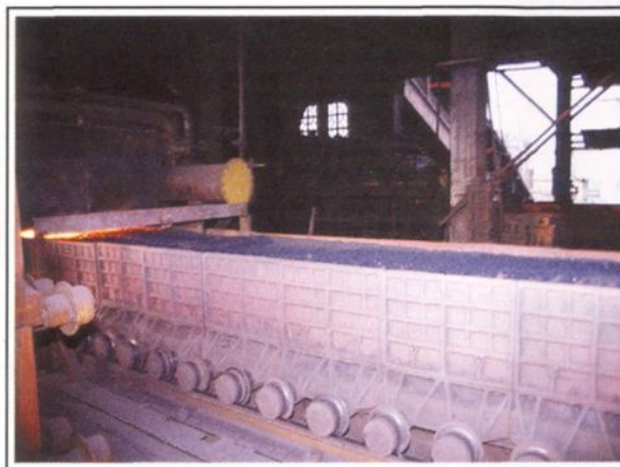
烧结机正在运行。
