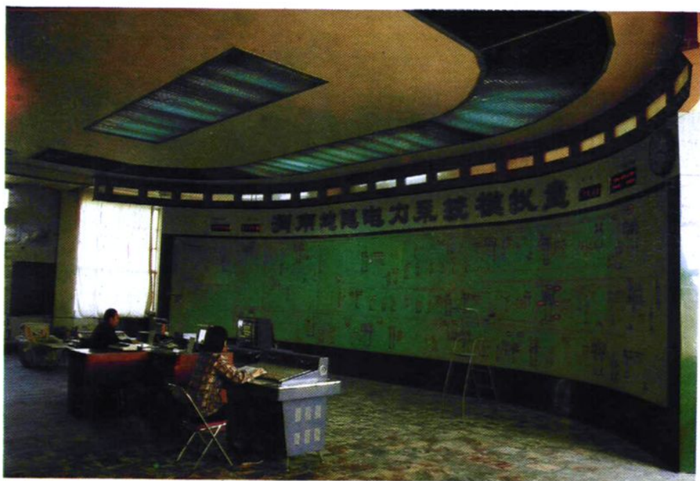
渭南地区电力调度室
