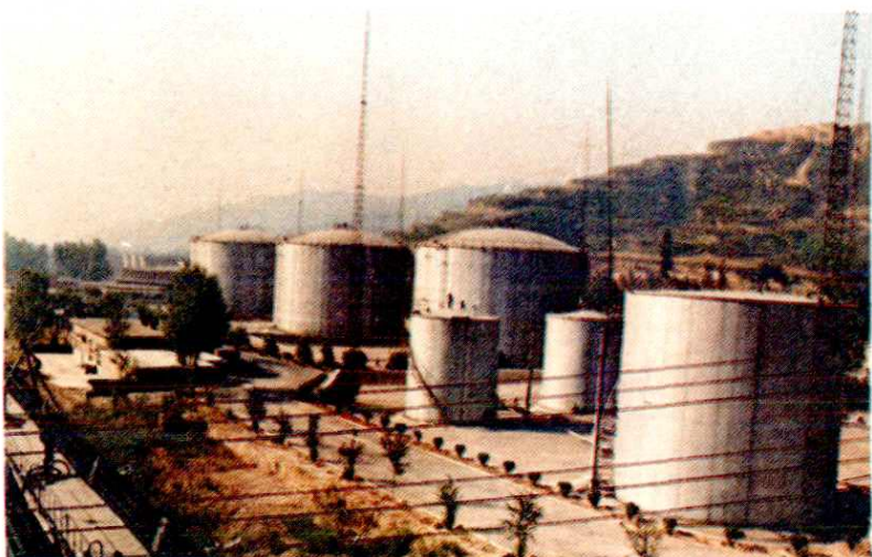
散装钢质油罐设施
