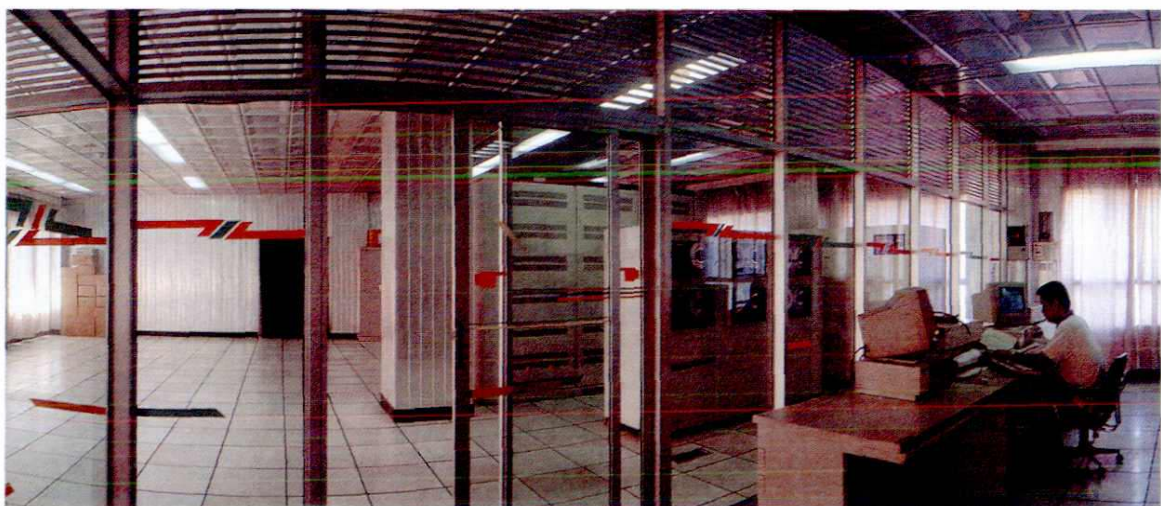
县邮电局万门程控电话交换机机房
