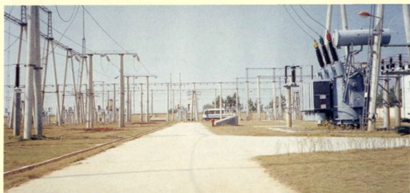
▶ 110千伏桥头变电站（1996年建成）
