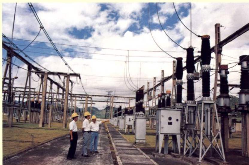
◀ 英德市第一座220千伏英德变电站（1993年12月投产）
