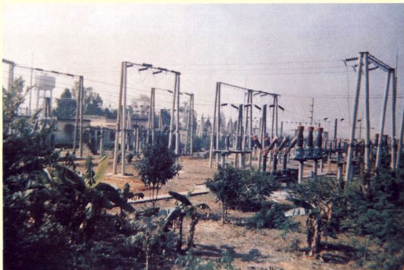
▶ 英德市第一座110千伏浚阳变电站（1963年7月投产）
