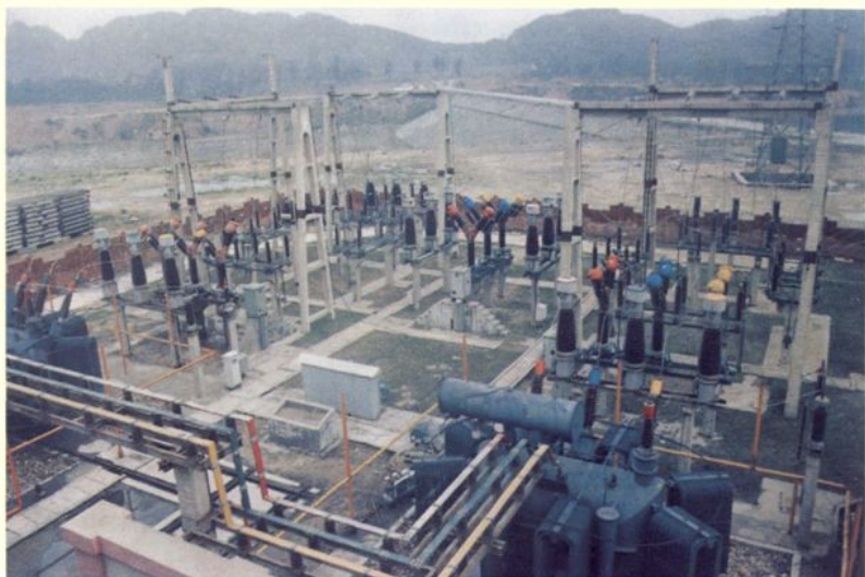
▶ 英德市白石窑水 电厂110千伏升压站 （1999年建成）
