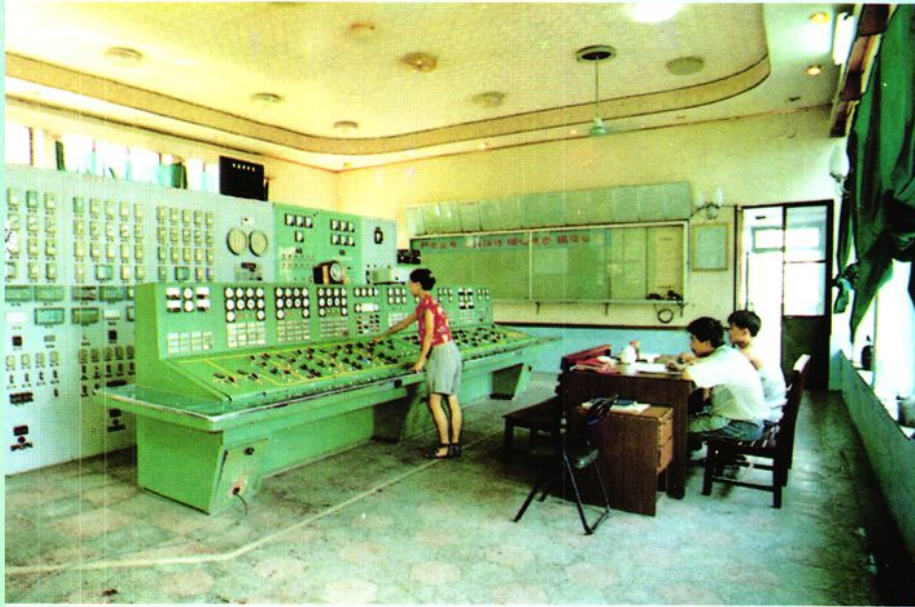
◀ 永安发电所中央控制室
