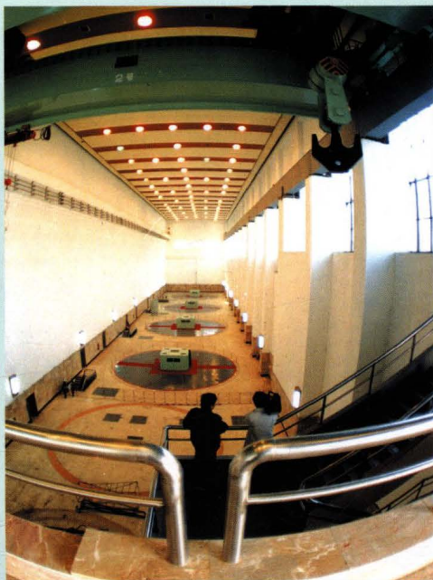
1995年10月全面投产后电站厂房内景
