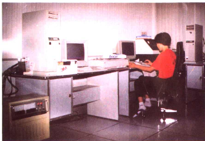
杭州市分行 信用卡部機房一角
