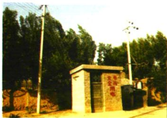
农村配电工程
