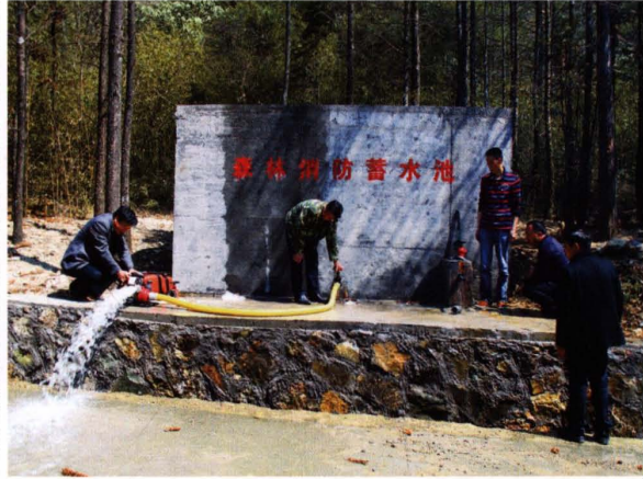
2013年3月6日，灭火水泵维护
