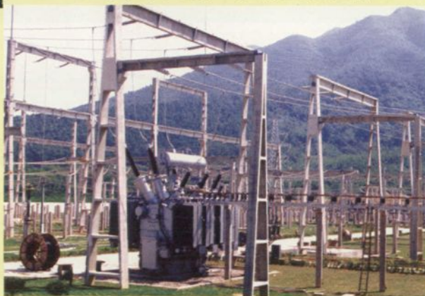
▼ 220千伏变电站三乡站主变压器
