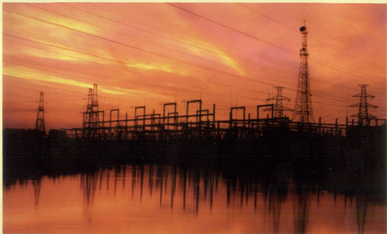
▲ 第一座220千伏变电站中山站
