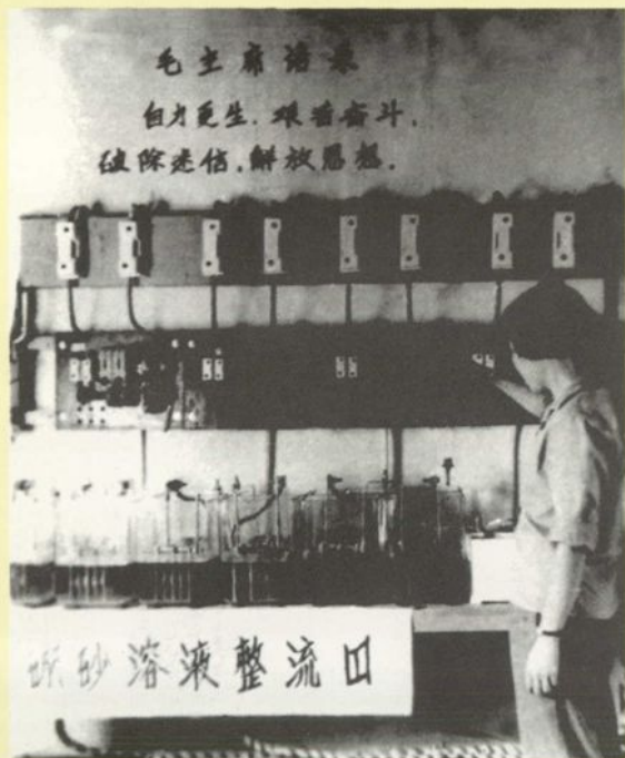
▲ 70年代，自力更生，土法上马，在变电站利用硼砂液作整流。
