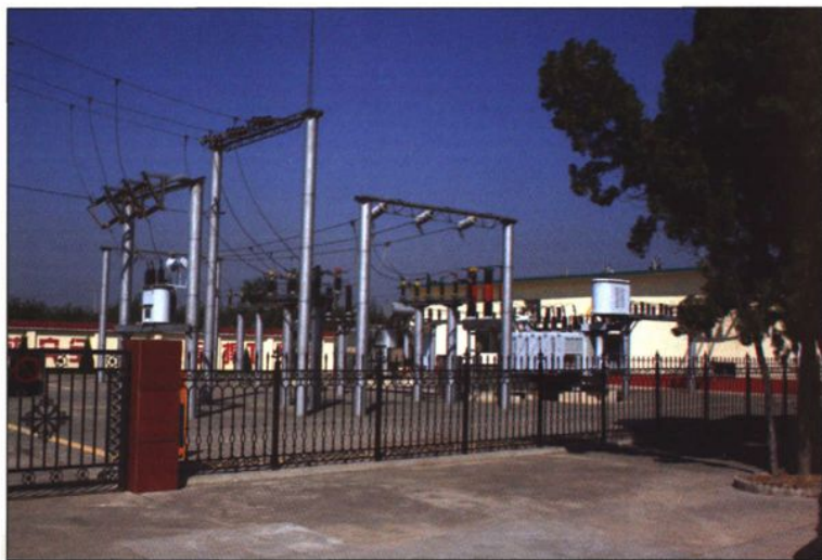
新改造的35千伏曹庄 变电站
