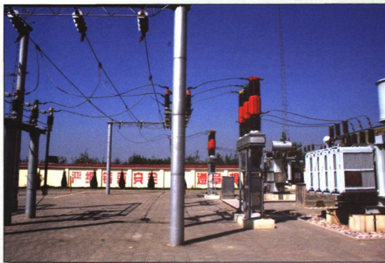
安全可靠的输配电 设备
