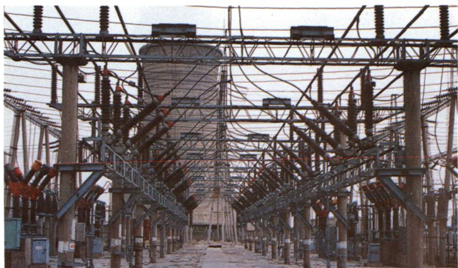
投产运行中的变电站
