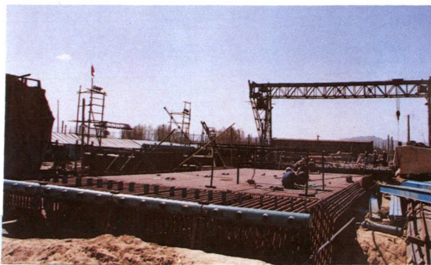
锅炉水冷壁组合
