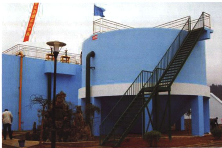
图21 县城污水处理设施（2009年摄）
