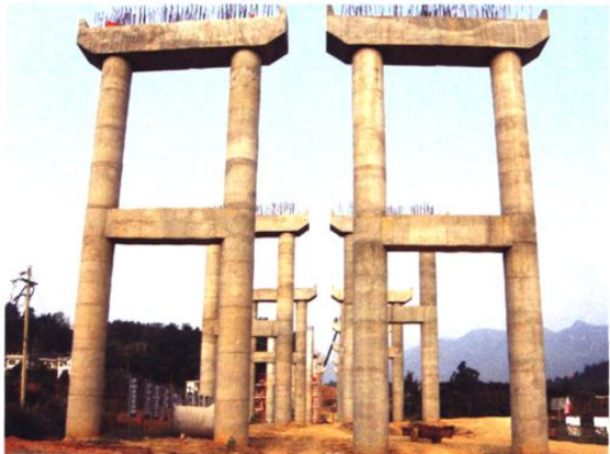
图29 正在建设中的杭州至瑞丽高速公路湄潭合同水段的高架桥 (2011年摄)
