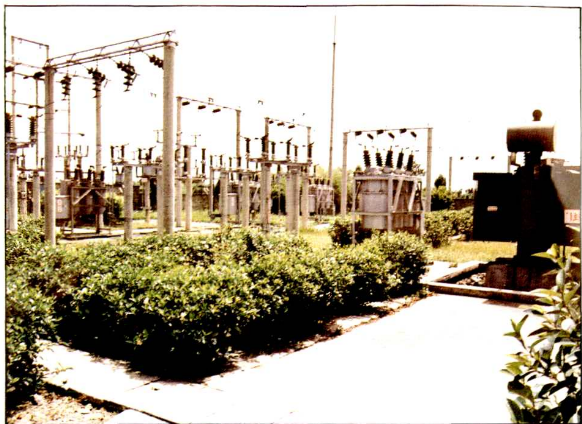
▲ 1982年建成的35千伏下楊變電所
