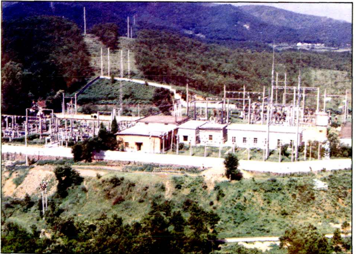
▼ 110千伏武義變電所全景
