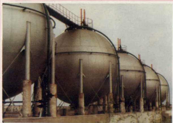
兰州石油化工机器厂为杭州煤气公司设计制造安装的球罐区
