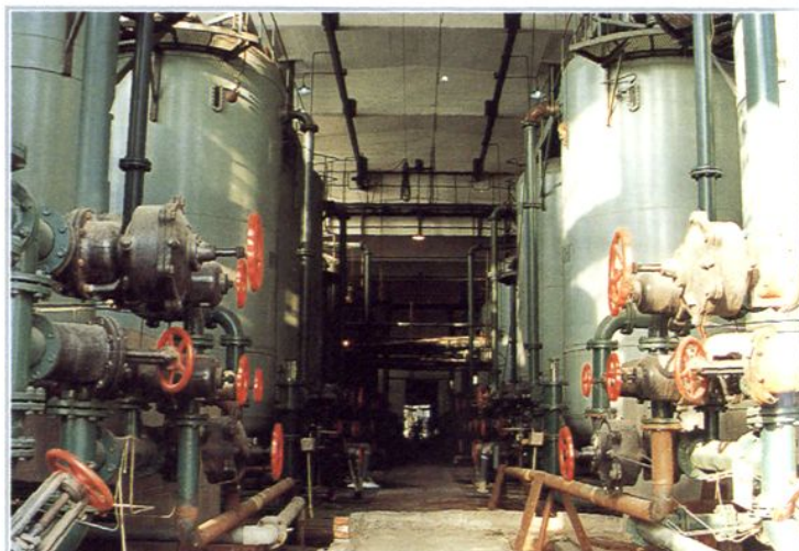
每小时供水400吨的化水设备
