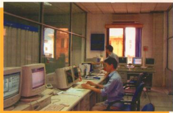
程控机房一角
