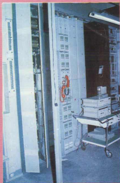
▲市局光纤通信终端设备一角。
