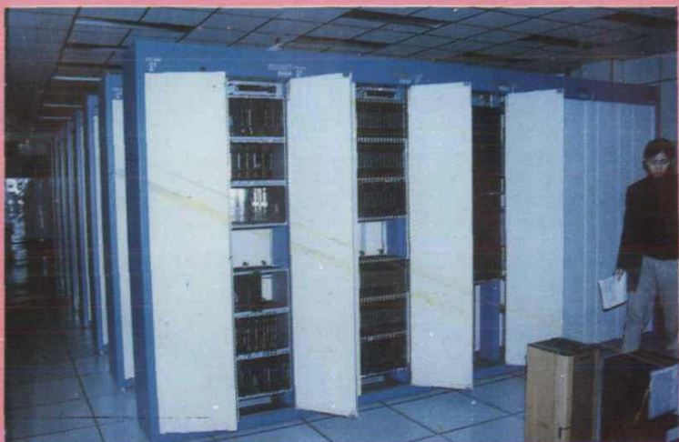
▲市局市话自动机房控制室一角。
