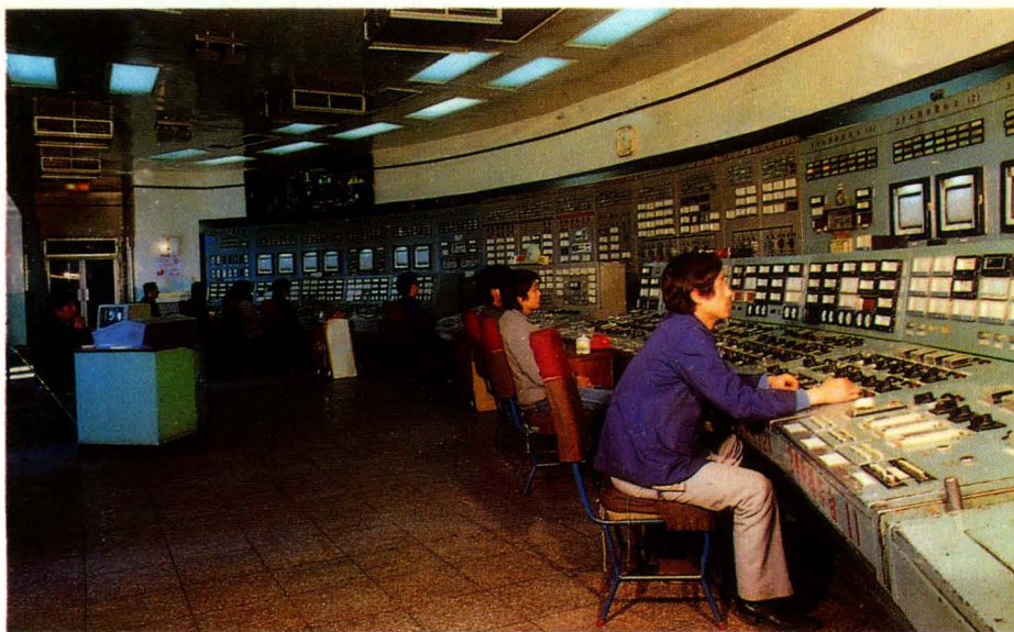
二单元主控制室
