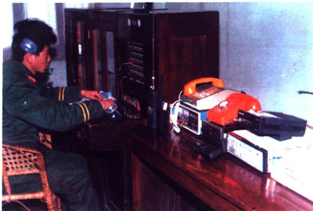
50門有綫電話總機和無線通信基地電台
