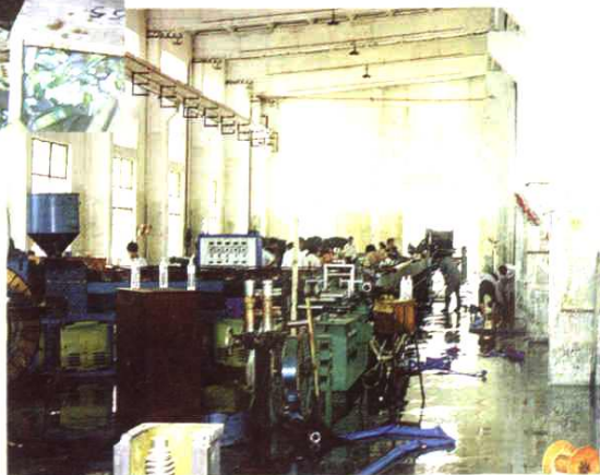
发电厂受灾现场
