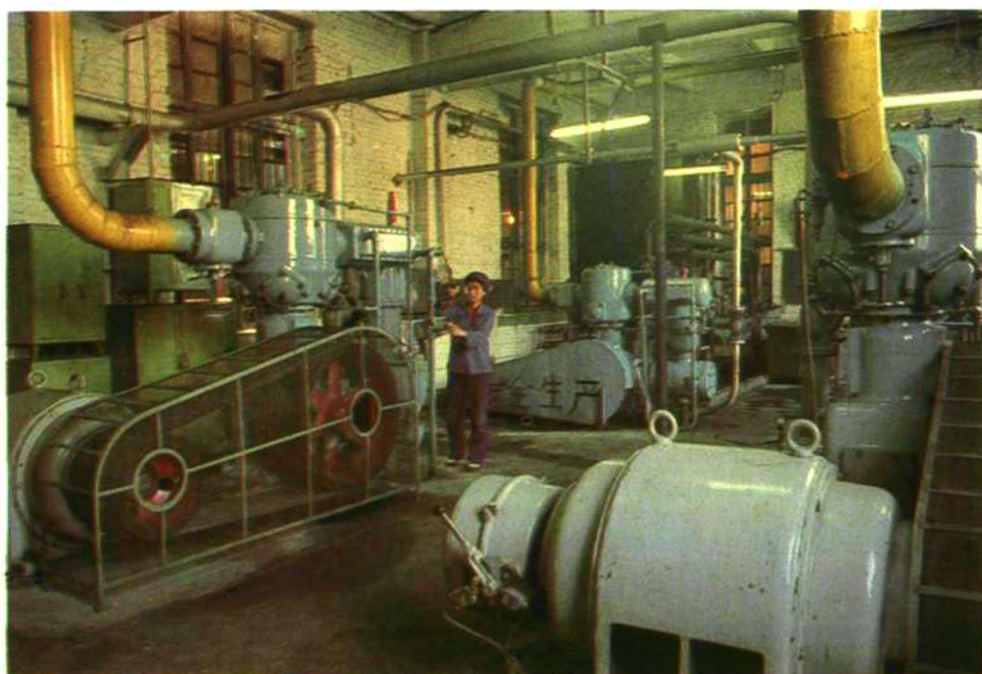
动力车间动力站
