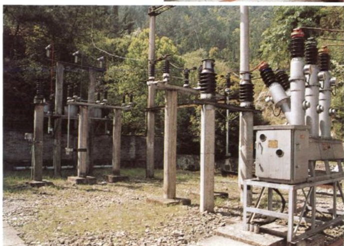
一级电站升压站
