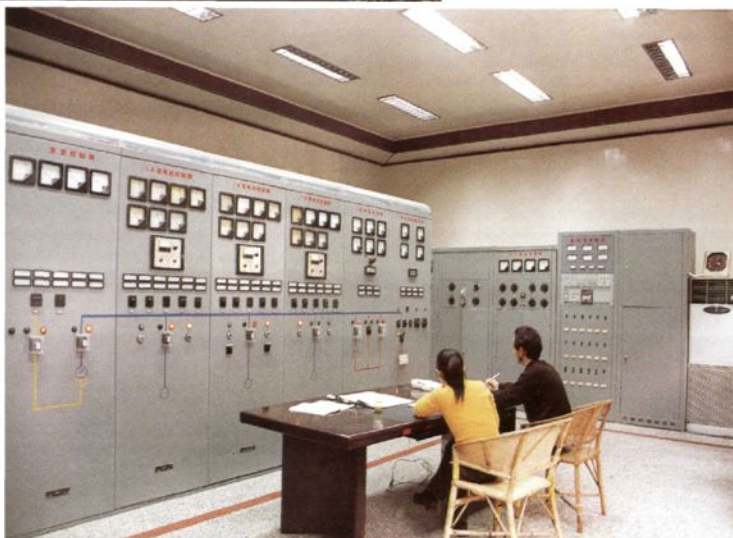
一级电站中控室
