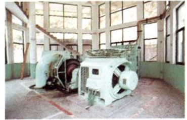
大坝电站发电机组
