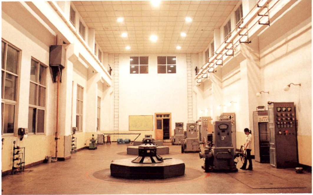
一级电站厂房
