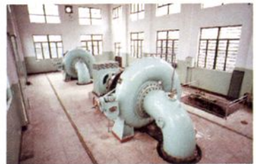
红旗渡槽电站发电机组
