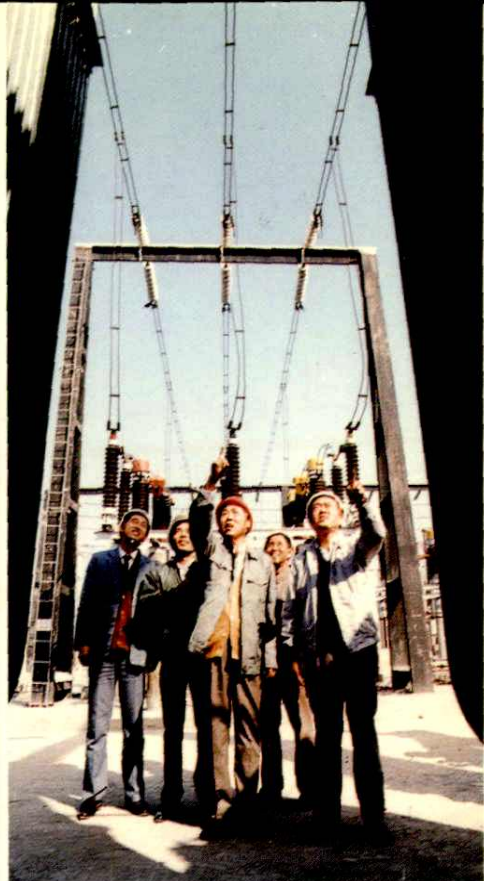
局领导在升压站检查安全情况
