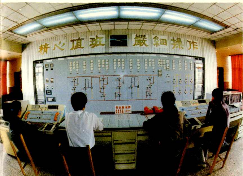
500 千伏任庄升压站控制室
