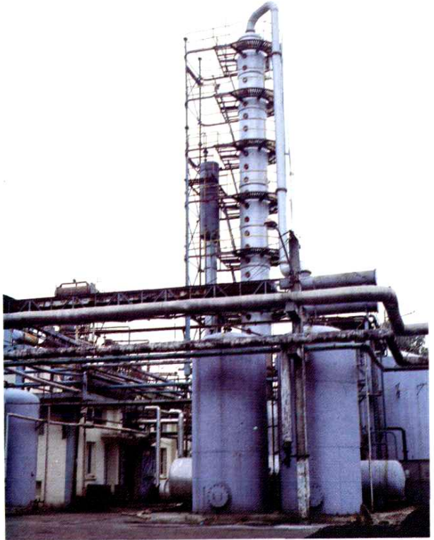
上海人民制药厂医药中间体蒸馏反应塔
