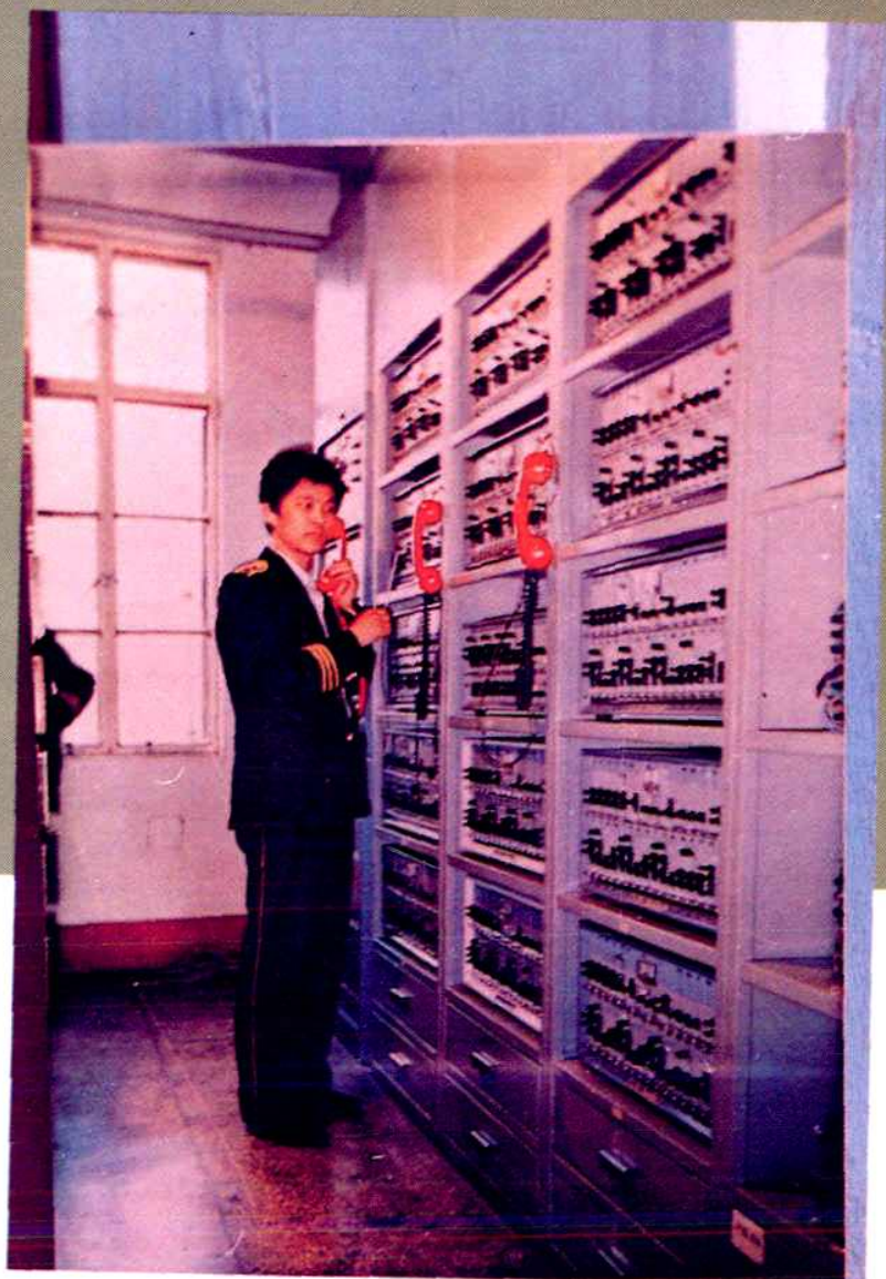
机务人员在机房测试
