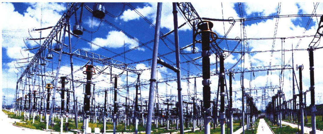
◆ 500千伏凤仪变电所
