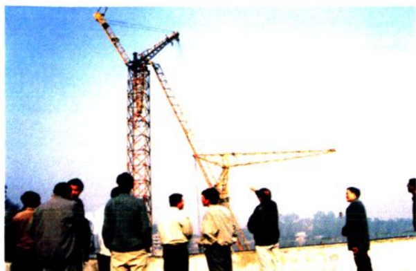
1998年12月21日，市劳动安全监察部门派员在公路处建筑工地塔吊臂断裂事故现场调查
