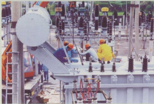
◀ 1995年3月8日，舟山市第一座110千伏变电所—普陀变电所建成投运
