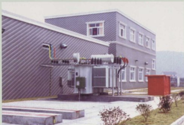
▶ 2003年12月，舟山市第一座综合自动化变电所—35千伏马岙变电所建成投运
