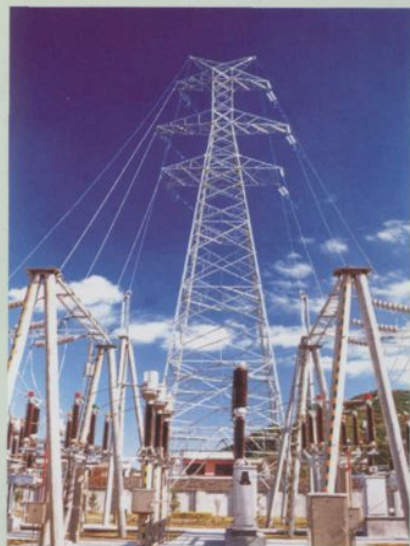
▲ 110千伏岱山变电所
