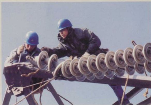
▶ 1998年10月，110千伏大陆至舟山交流双回路电力联网工程动工兴建
