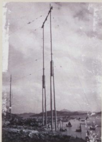
◀ 1970年12月，舟山第一条跨海架空输电线路—6.3千伏舟山本岛至长峙岛输电线路建成投运
