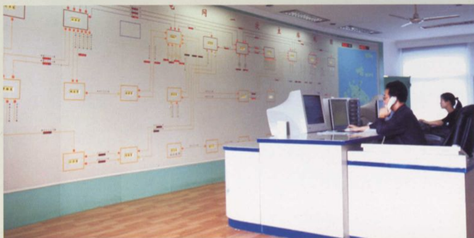
▲ 舟山市电力调度所调度指挥中心
