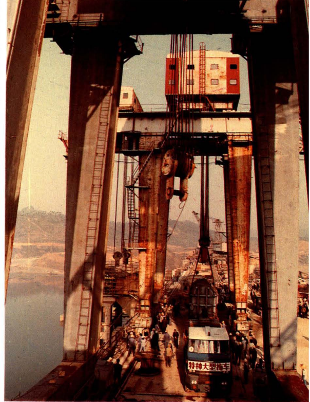
大化水电站重135吨主变压器运抵坝面
