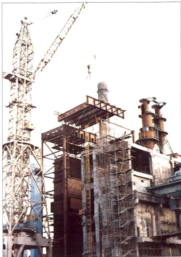
乌鲁木齐石油化工总厂动力站 65 吨/小时 锅炉组合件起吊就位
