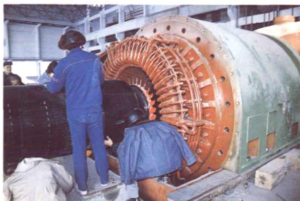
红雁池电厂 5 万千瓦机组发电机串转子
