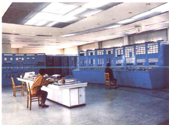
公司安装的玛纳斯电厂主控制室
